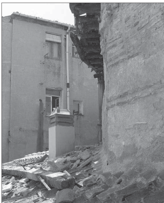
Los vecinos subrayan el riesgo que supone el estado del edificio
