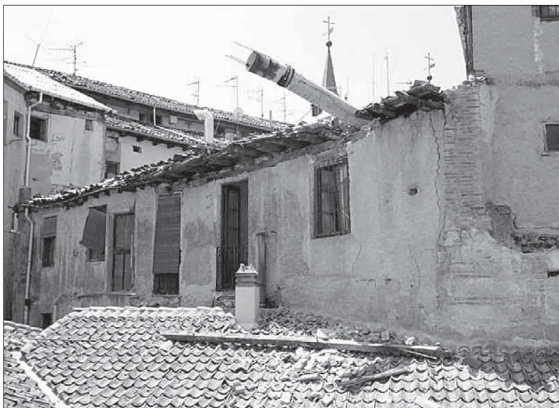
El inmueble sufre derrumbes desde el pasado mes de enero, según señalan los vecinos
