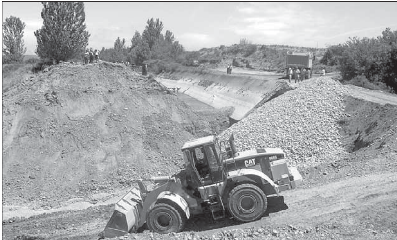
Aspecto de los trabajos que se realizan en la zona que se derrumbó el pasado viernes
