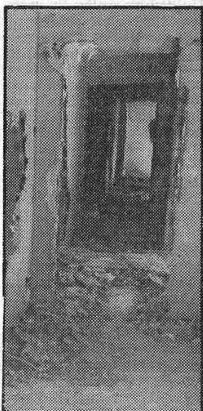
Las casas que van siendo abandonadas por los vecinos, para irse a las nuevas torres, son objeto de un constante destrozo
