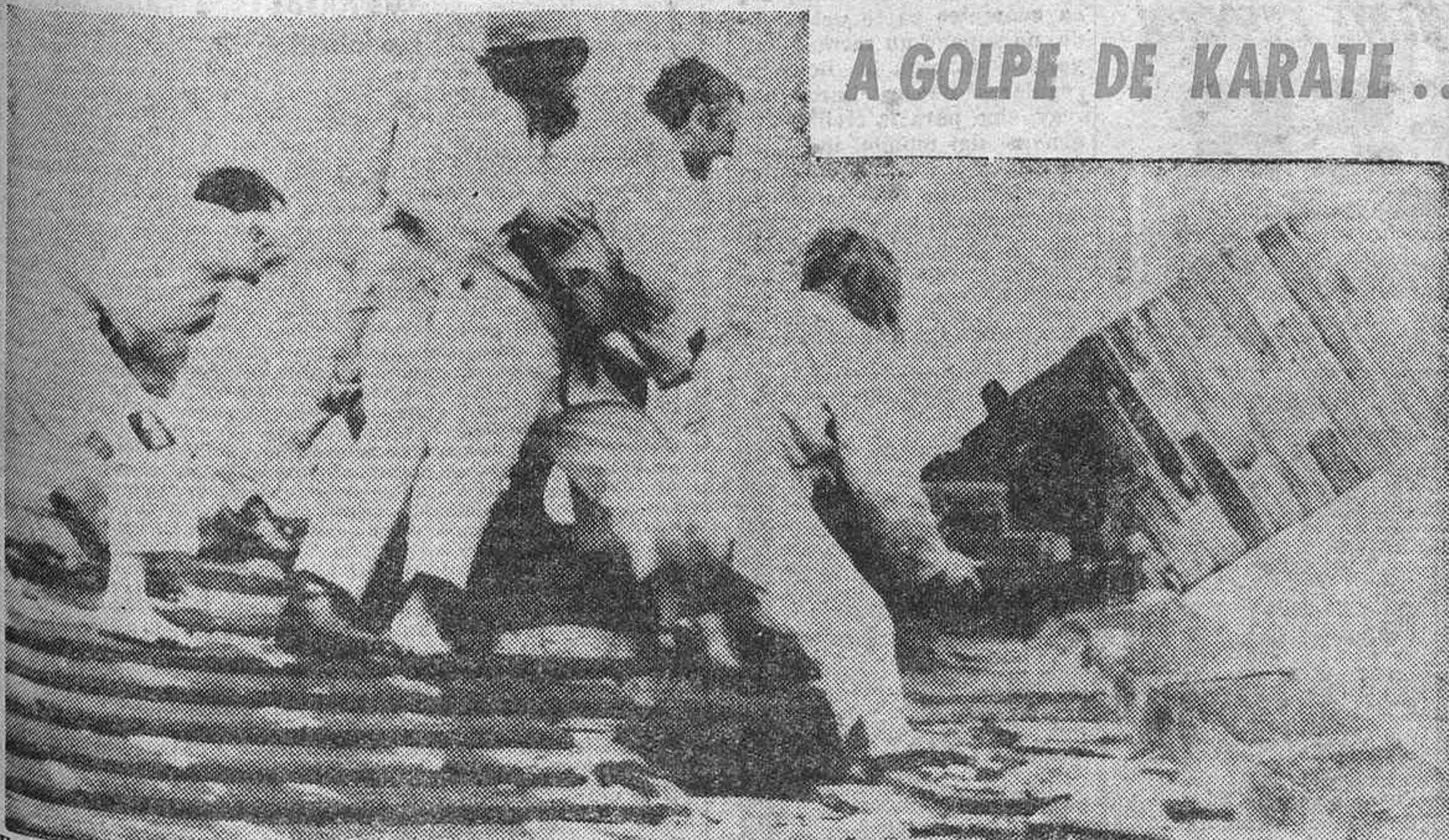
Un grupo de aficionados ingleses al deporte nipón del karate decidieron utilizar las reglas de este deporte—cosa insólita—para la demolición de un edificio de ciento cincuenta años de antigüedad. Emplearon sólo la cabeza, las manos, los pies... La foto recoge el momento en que los partidarios del sistema comienzan el ataque a la chimenea. (Telefoto Cifra Gráfica.)
