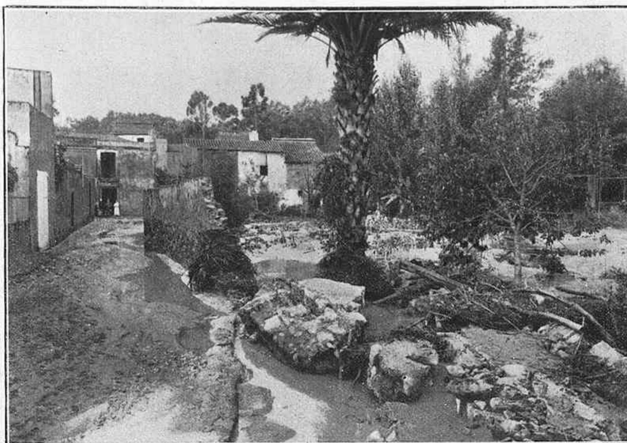
Restos de un muro destruído por las aguas
