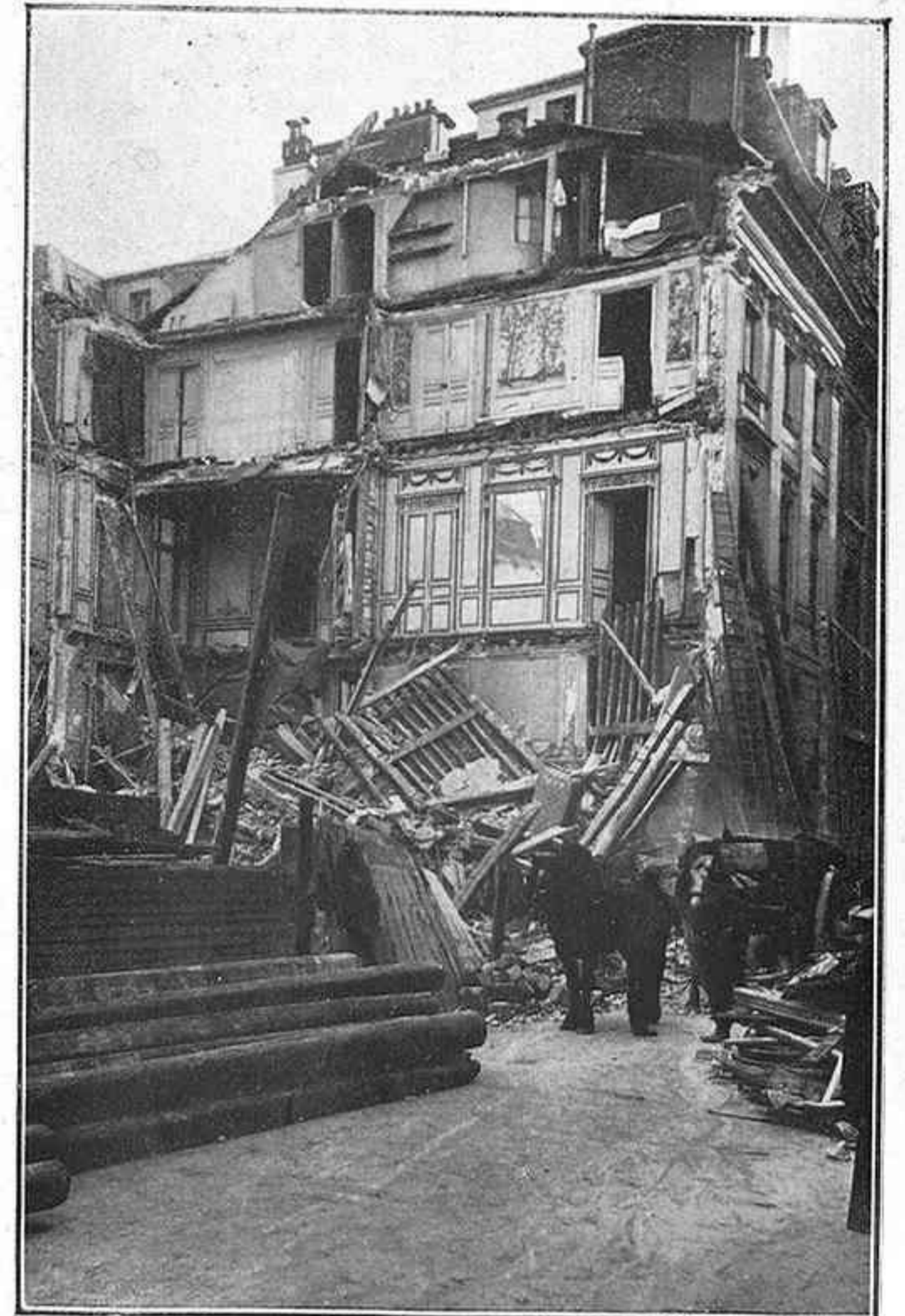
París. - Derrumbamiento de parte de una casa de la calle de Anjou, entre cuyas ruinas perecieron los esposos Froment-Meurice. (De fotografía de Carlos Trampus.)
