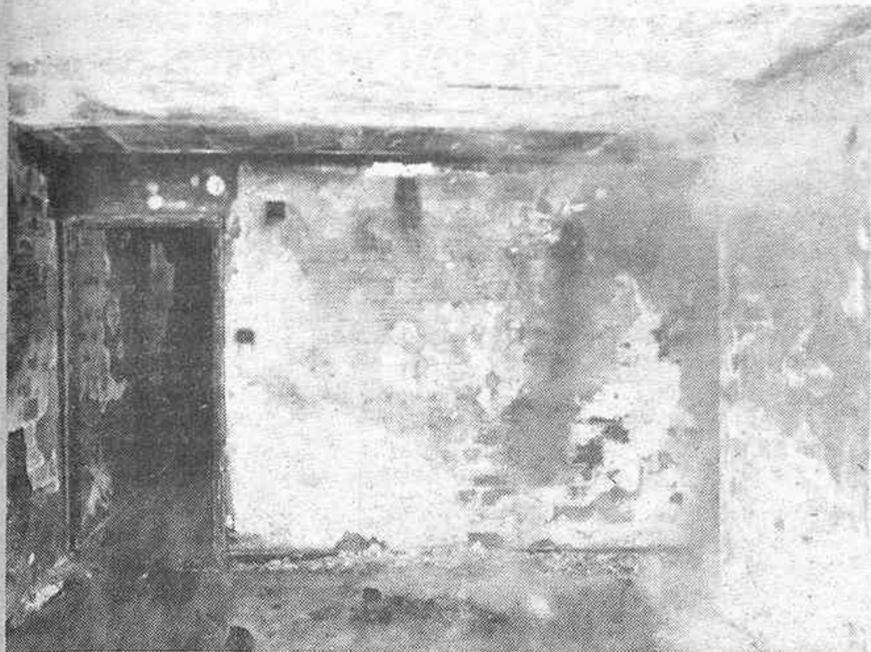
El piso incendiado quedó totalmente calcinado.
