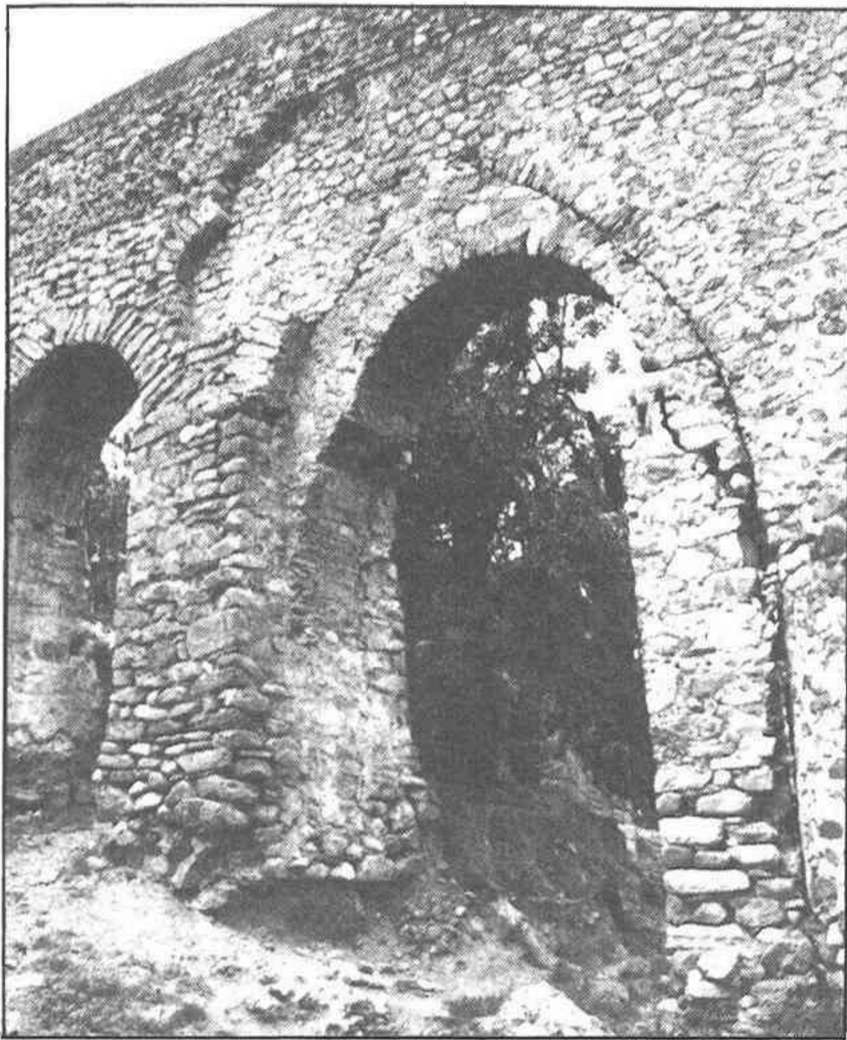
Algunos arcos presentan peligro de derrumbamiento / MANGRIÑAN
