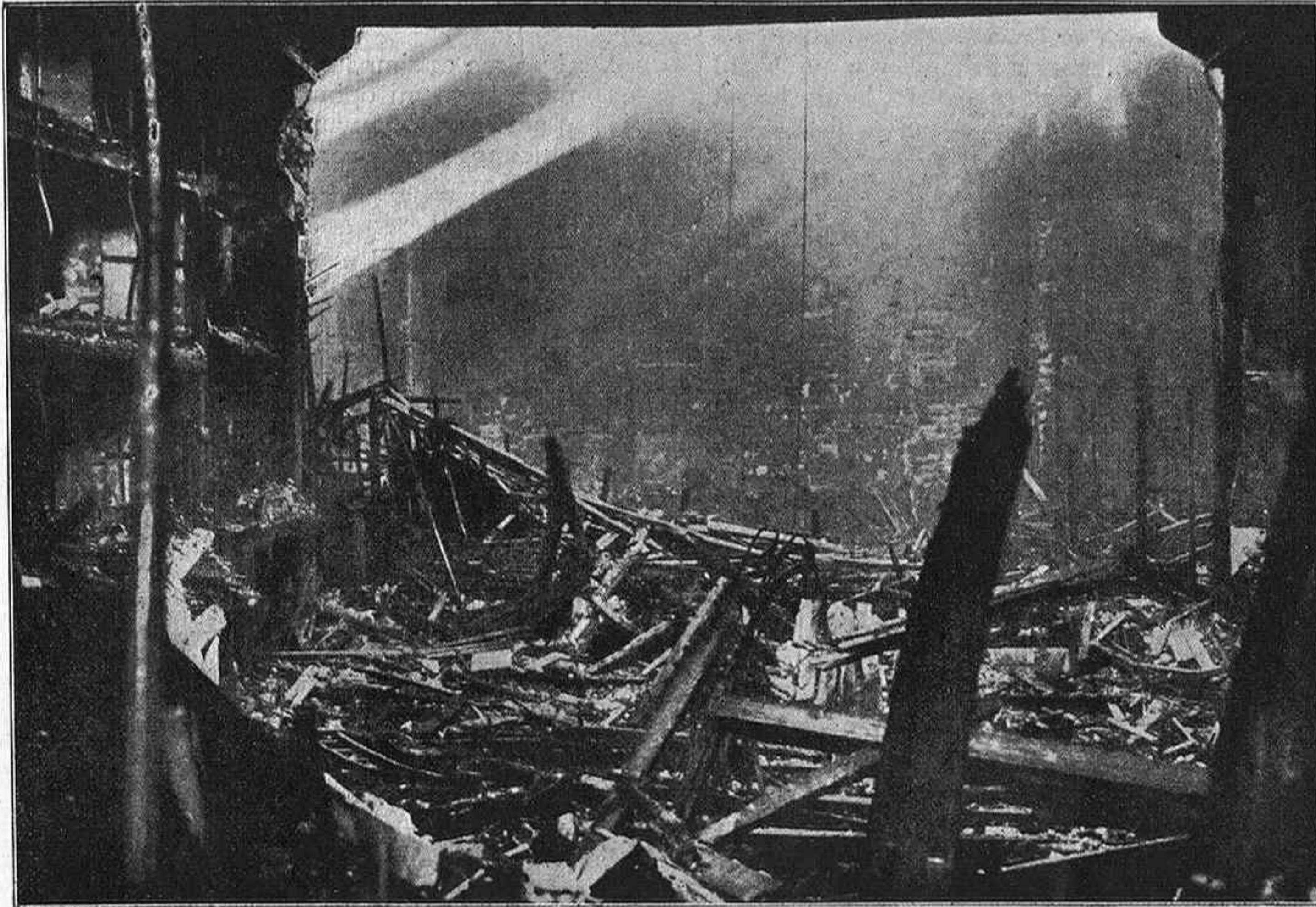
PARÍS. — Incendio del Teatro Francés. Interior de la sala de espectáculos después del siniestro
