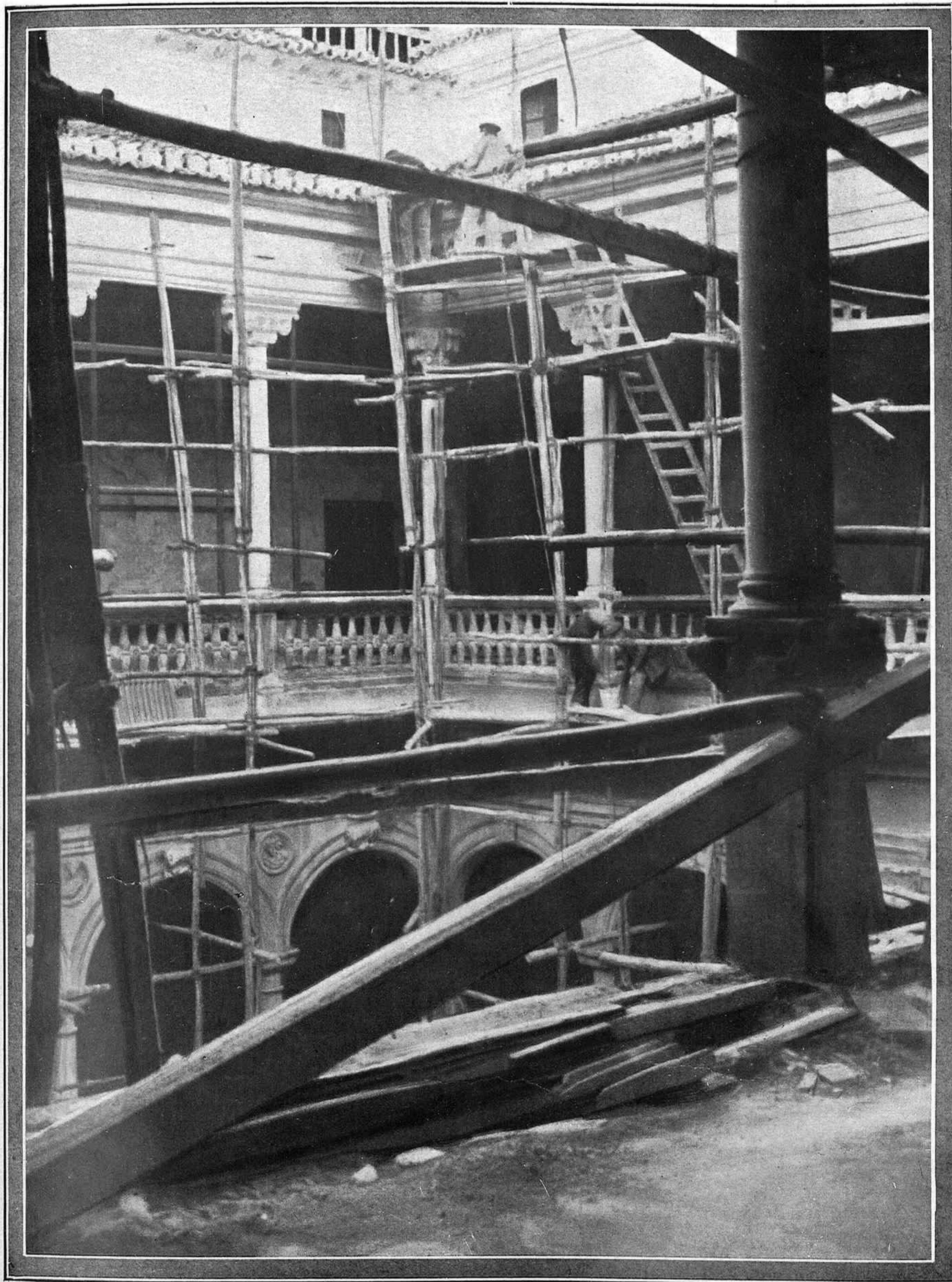
Galería alta del segundo patio de la Audiencia durante las obras de restauración
