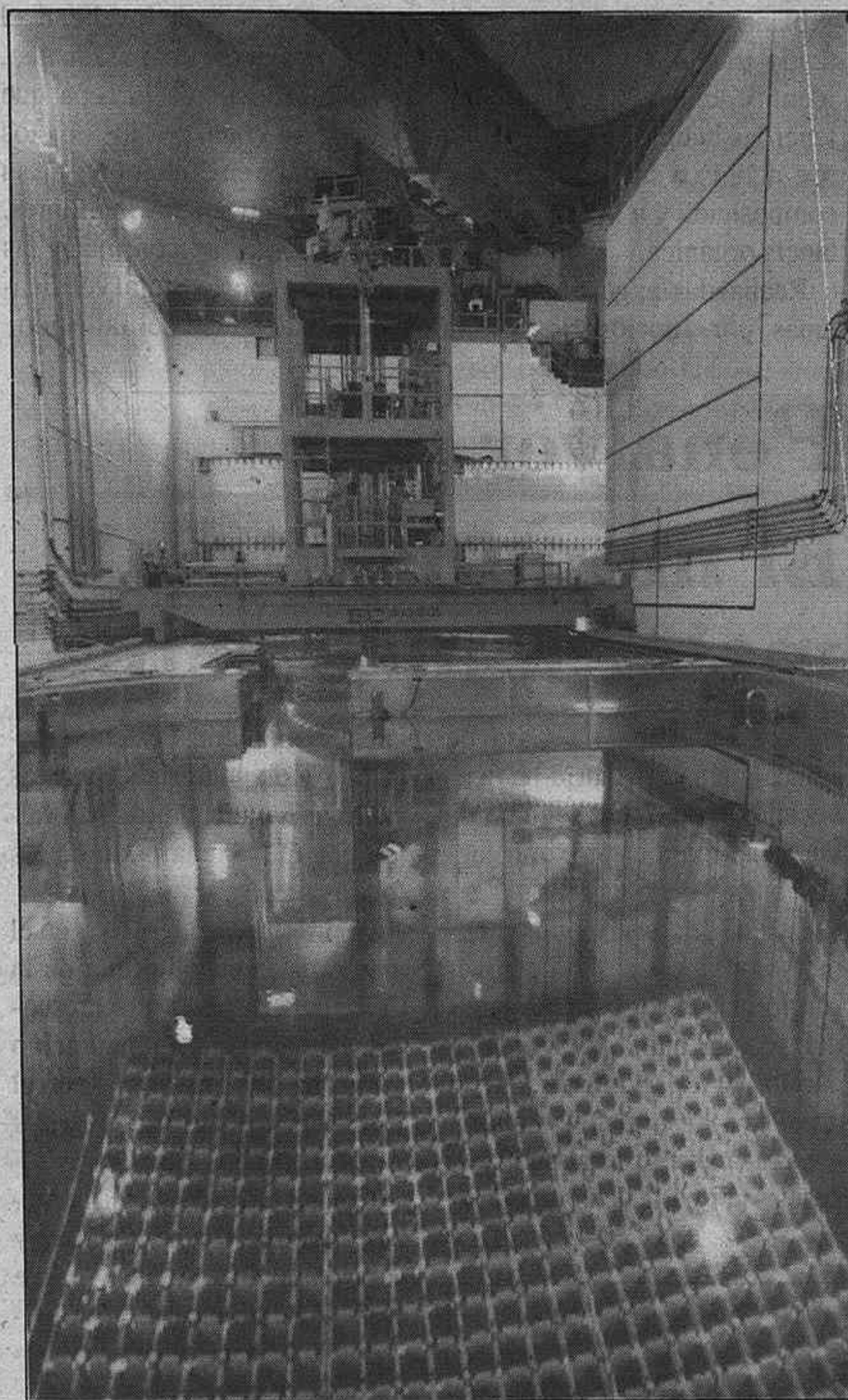
En Trillo, el combustible gastado se almacena en esta piscina. Su capacidad se agotará en 1.997 y para entonces habrá que construir otra o meter los bidones en contenedores.
