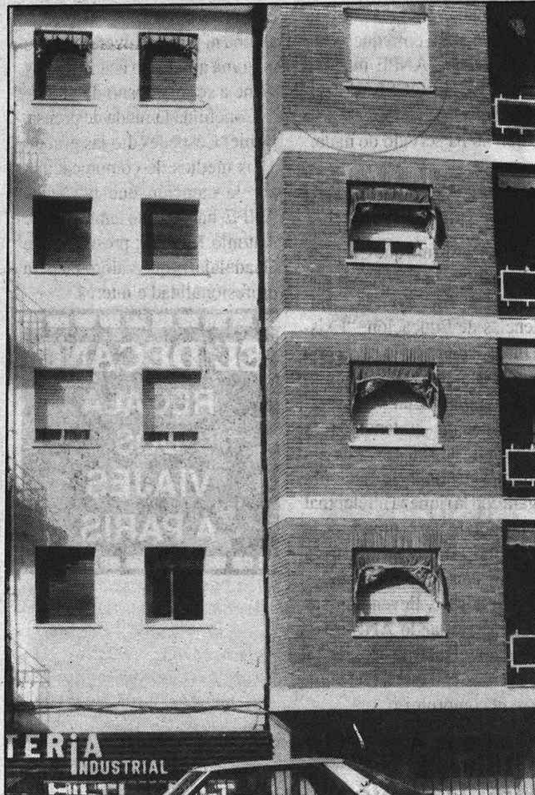
El edificio de la derecha (en tonos oscuros) se ha ido progresivamente desplomando, lo que ha llevado al desalojo de sus vecinos
