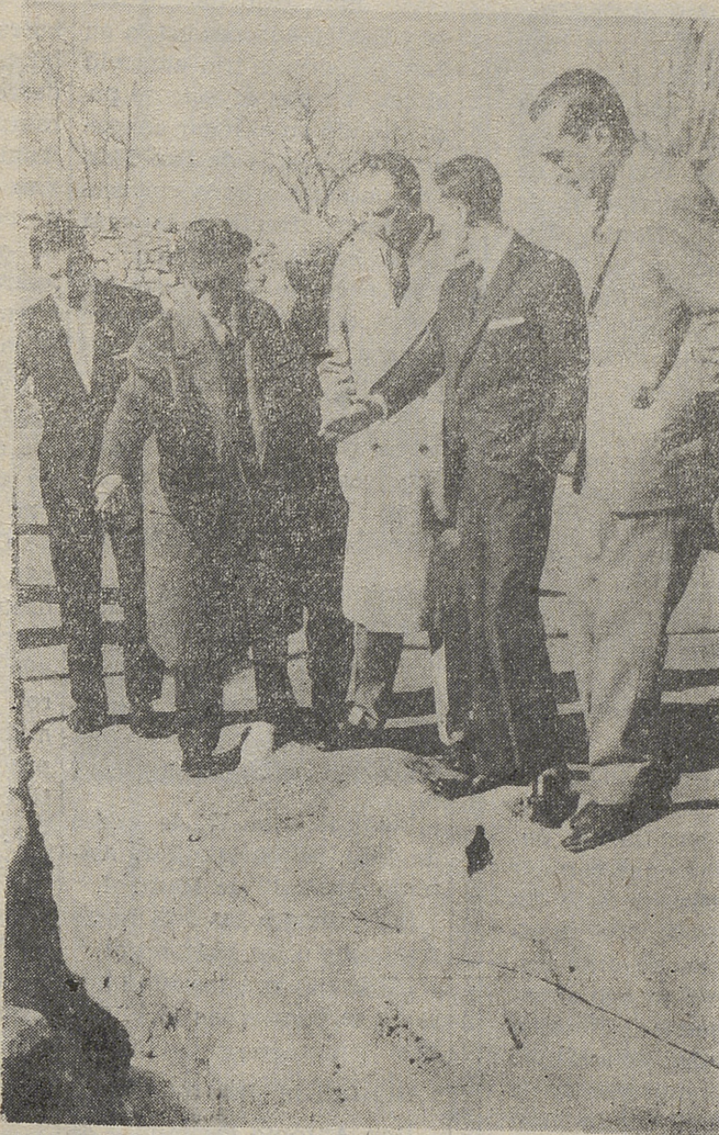
El sub-director general de Arquitectura con las autoridades abulenses examinan los desperfectos ocasionados en el colector
