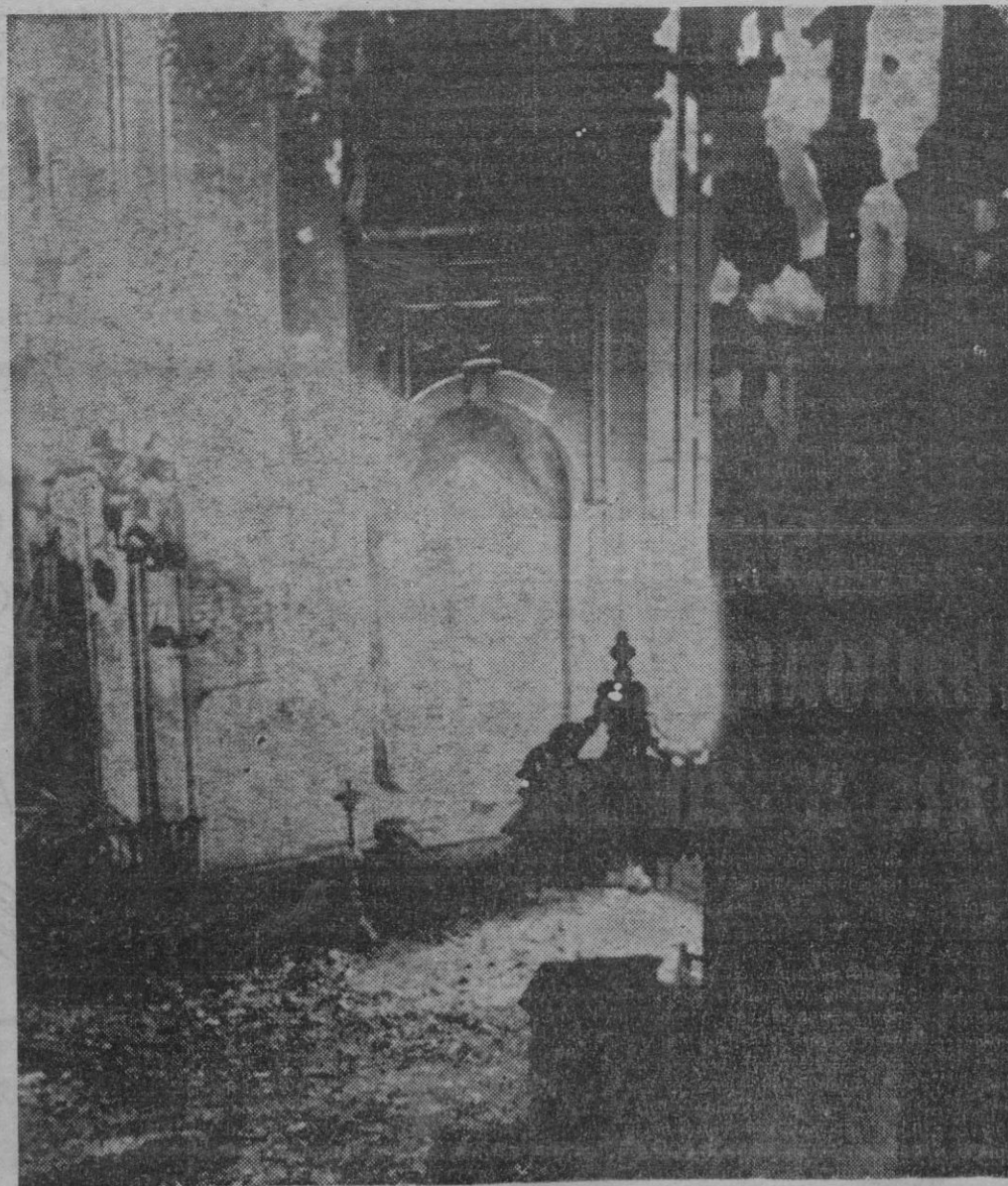
CORDOBA. — Un importante incendio, al parecer intencionado, ha destruido la pasada madrugada la iglesia del antiguo convento de la Merced, ubicado en el edificio de la casa-palacio de la Diputación Provincial cordobesa. En la fotografía, aspecto parcial de los destrozos causados por las llamas en el interior del templo. — (Telefoto Cifra Gráfica).
