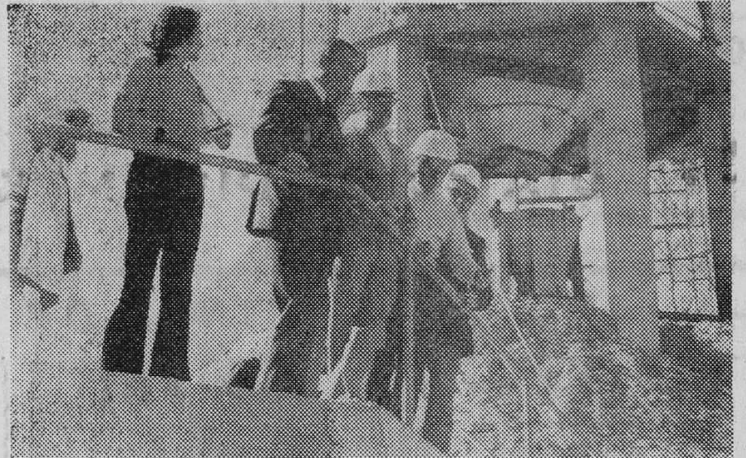
En la cúspide de lo que será el embalse de Quebrajano, las autoridades y visitantes contemplan las obras que actualmente se llevan a cabo en el lugar.
