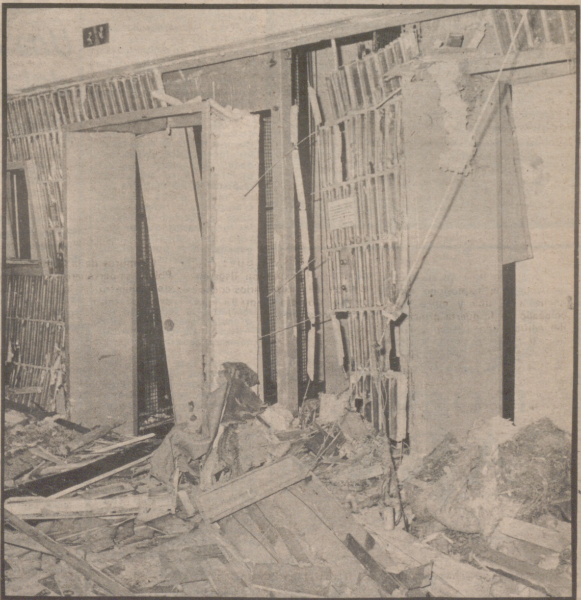
En la foto, los destrozos provocados por la segunda explosión en los ascensores de la Organización Sindical. (Foto Cifra Gráfica.)
