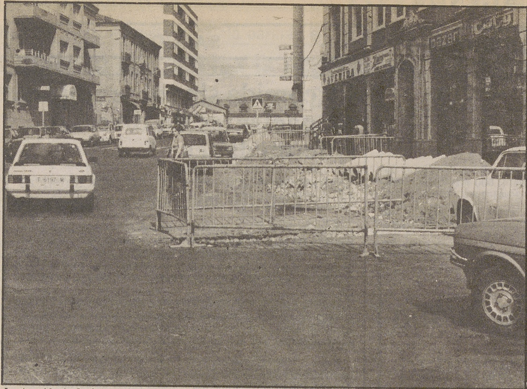
La Avenida de José Antonio conserva las ruinas de una calzada plagada de hoyos y zanjas
