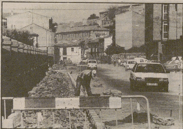
Los alrededores del monasterio de Santo Tomás sufren obras inacabables y asfalto destrozado
