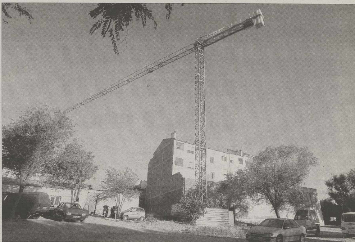
La grúa abandonada se ubica en la calle Ecuador y los vecinos la consideran un peligro. / R. SERRALLÉ
