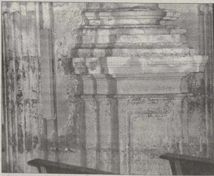
El deterioro es evidente./G. GONZÁLEZ
