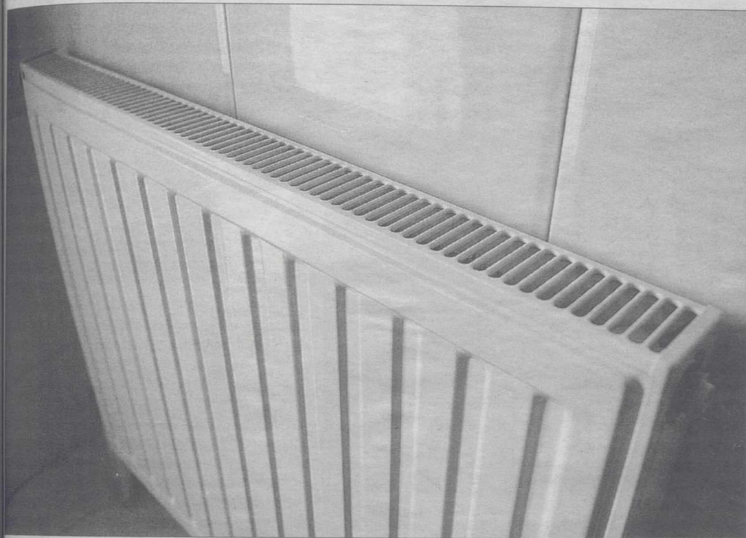
Ejemplo de sistemas de calefacción eficientes y en buen estado repercute en el ahorro energético. / LUIS LÓPEZ ARAICO
