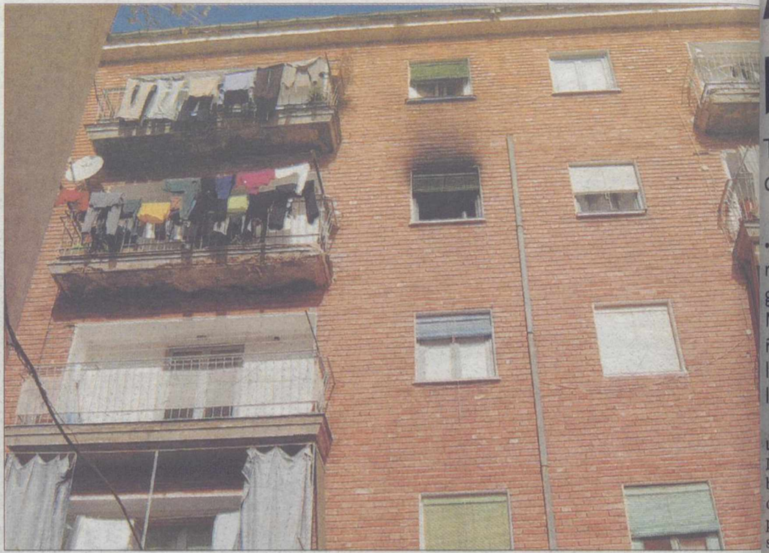
Edificio donde tuvo lugar el incendio./ANGEL ROMERO
