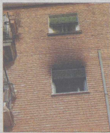
La habitación que sufrió los daños.
