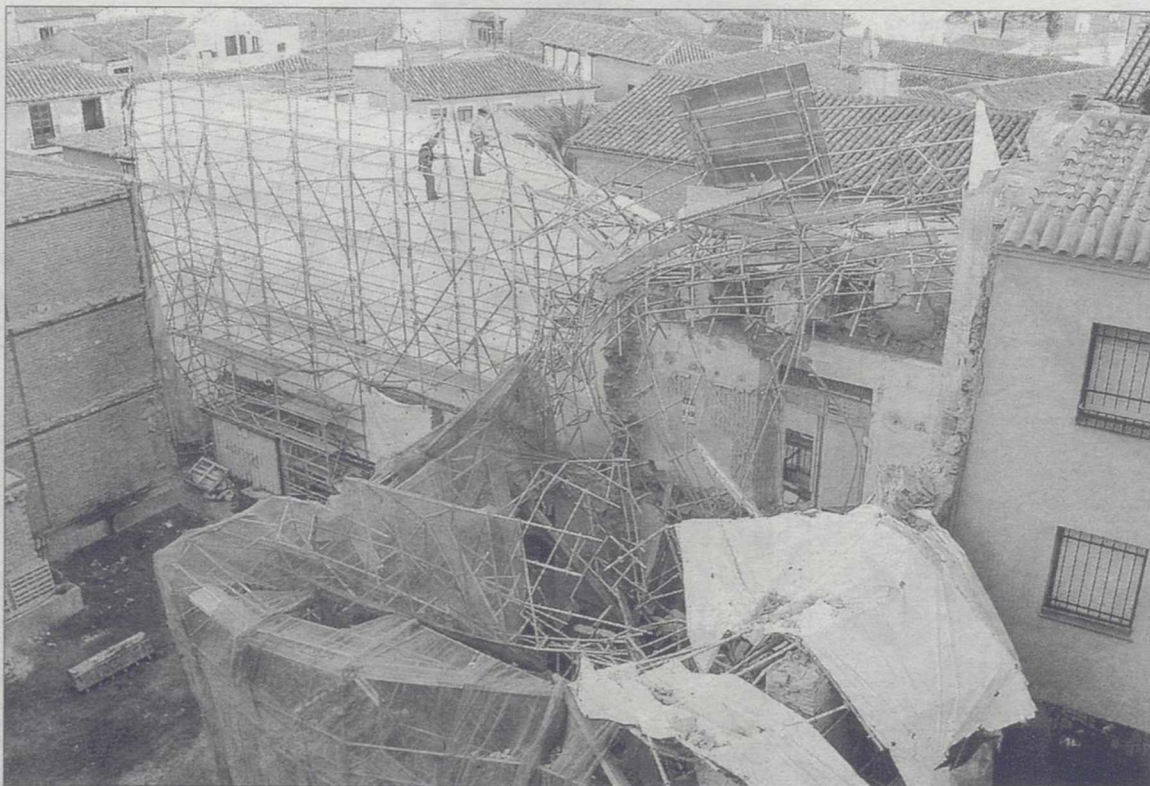
El andamio colocado en la torre evitó que el derrumbe ocasionara daños personales. / YOLANDA LANCHA
