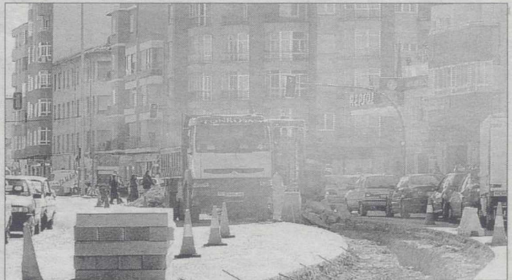
Una zanja ya cerrada, ha vuelto a ser abierta. / ARTURO PEREZ
