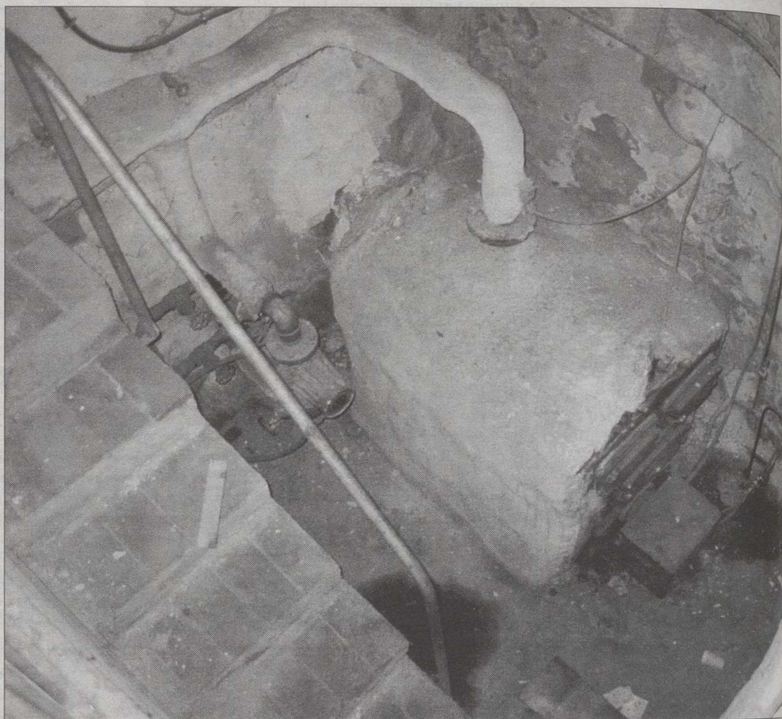
Estado en que se encuentran las calderas de la calefacción en el Teatro Regio./LA TRIBUNA
