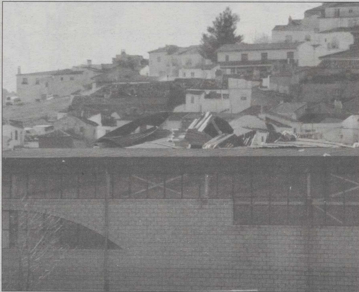
Los desperfectos en la cubierta están afectando al interior.
