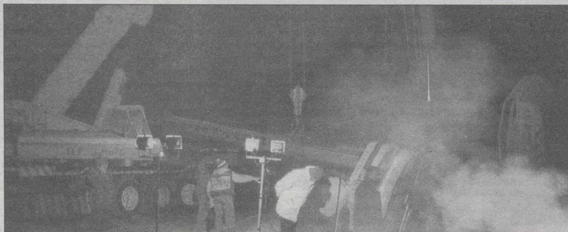
Fueron necesarias dos grúas para despejar la carretera.
