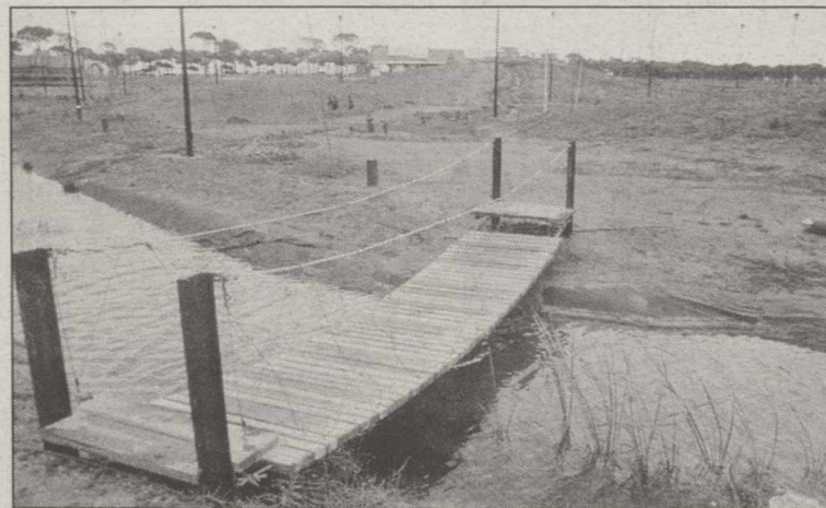
El parque de La Pulgosa sigue presentando deficiencias.
