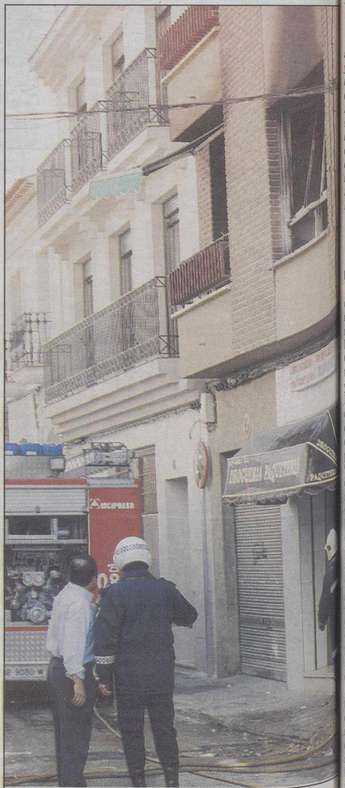
La explosión afectó ligeramente a la fachada.
