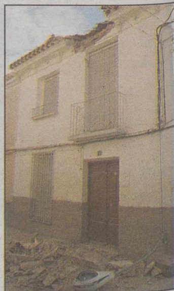
Los daños se quedaron en Murcia.
