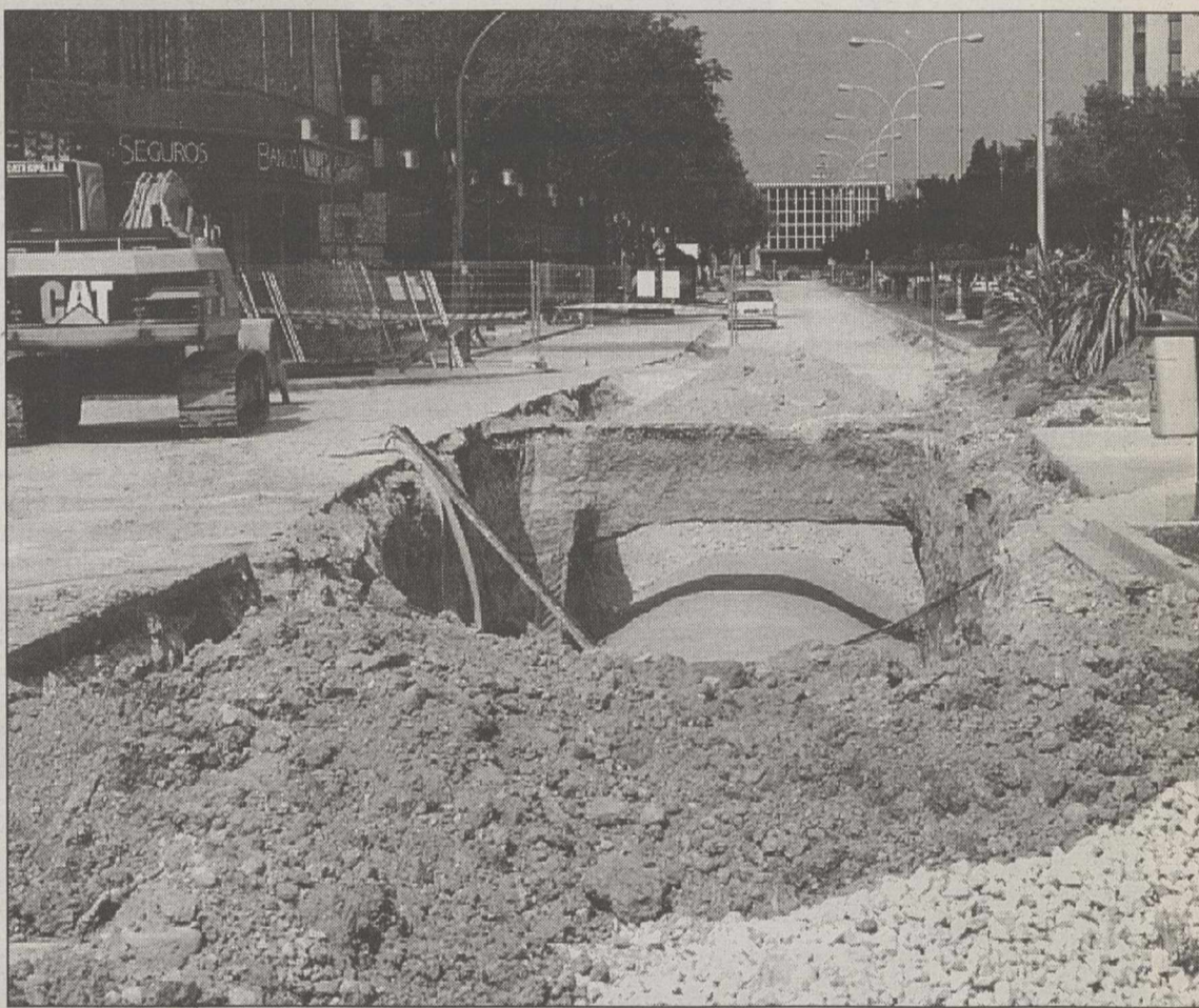
Las obras del colector de aguas pluviales se encuentran en El Sembrador.
