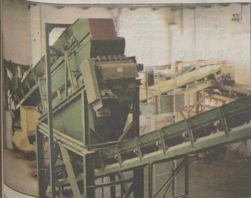
Planta de tratamiento de residuos de la Mancomunidad de Montejurra.
