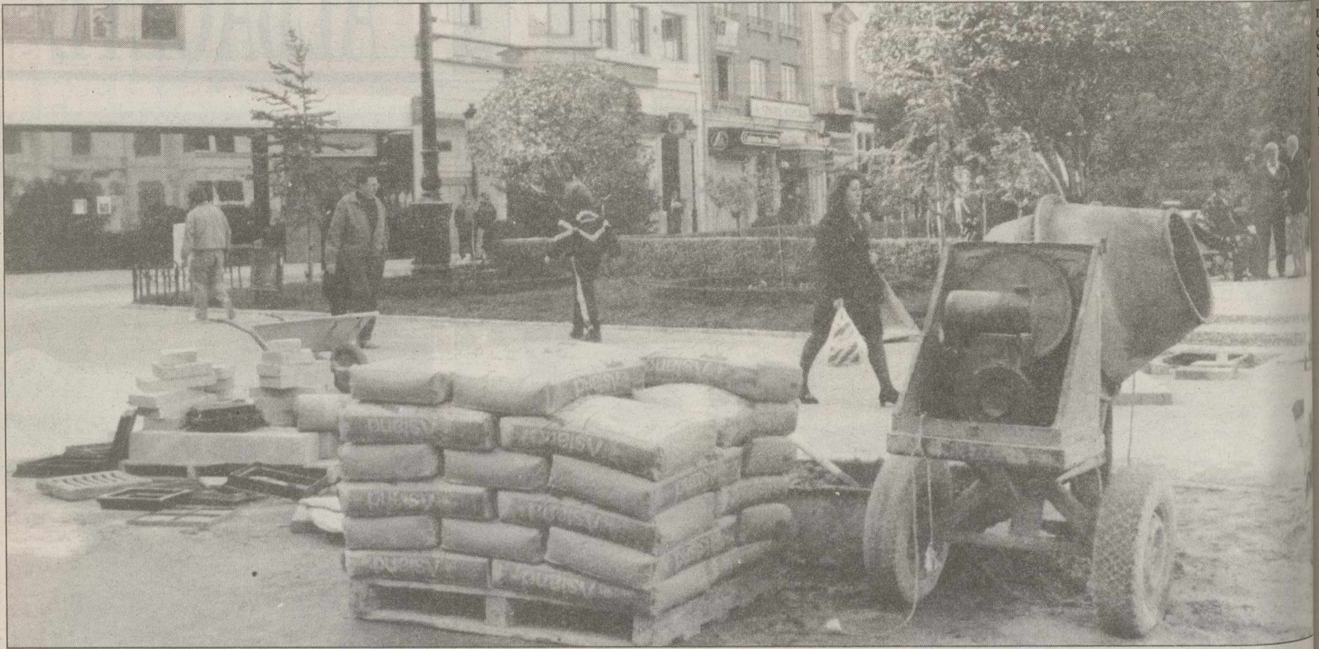
Hormigoneras, sacos de cemento, carretillas y adoquines forman parte del decorado de las obras de revitalización del centro que se están realizando.
