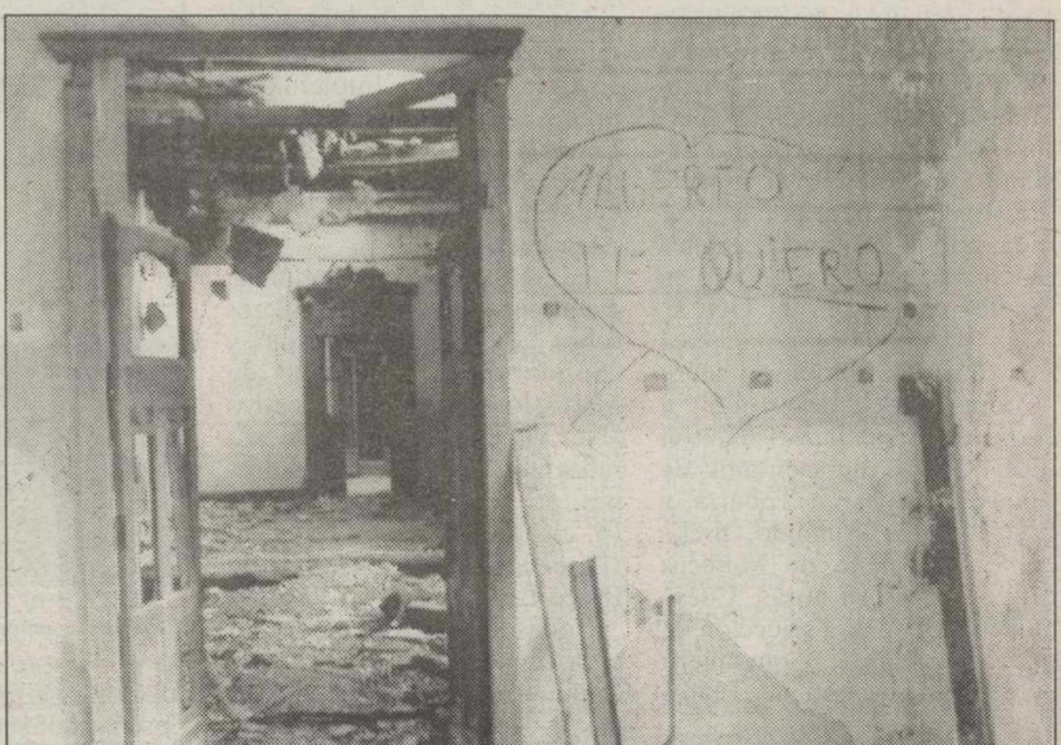
El deterioro que sufre y los daños que se ocasionan cada día que pasa son mayores.
