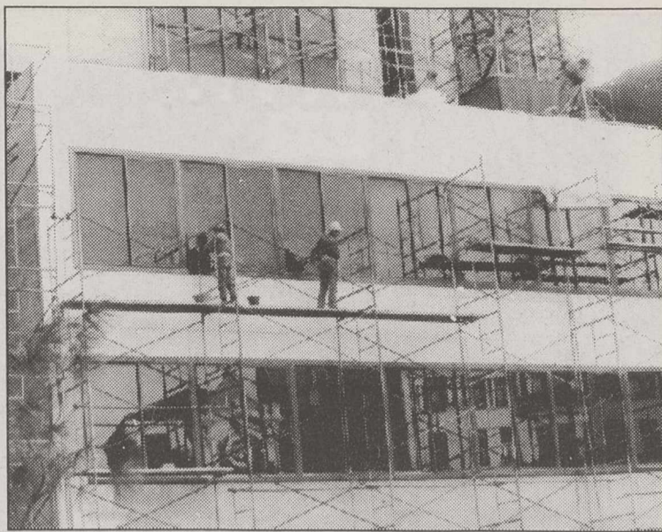
La construcción sigue siendo la rama en donde se dan más accidentes laborales.
