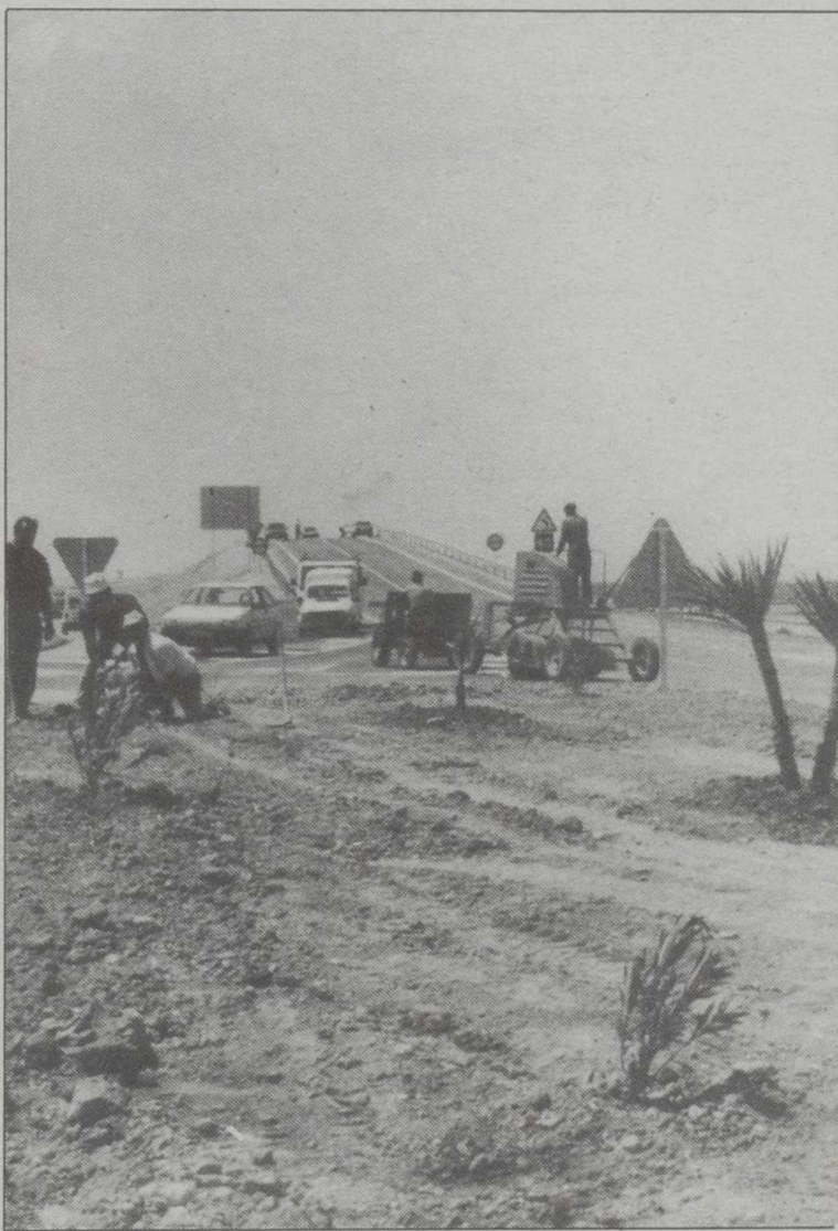
Seguirán trabajando en la terminación de los bordes de la calzada. LUIS MIGUEL
