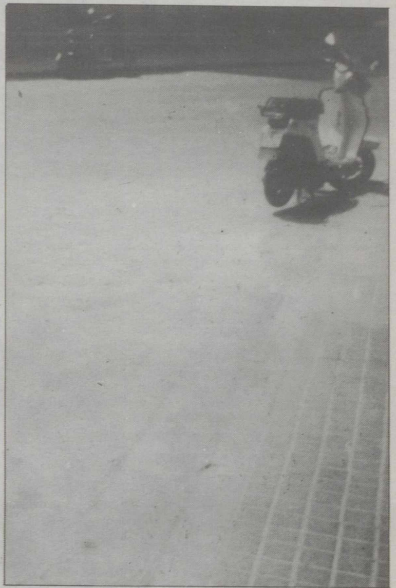
Estado de la calle Melchor Macanaz esquina Buenavista.
