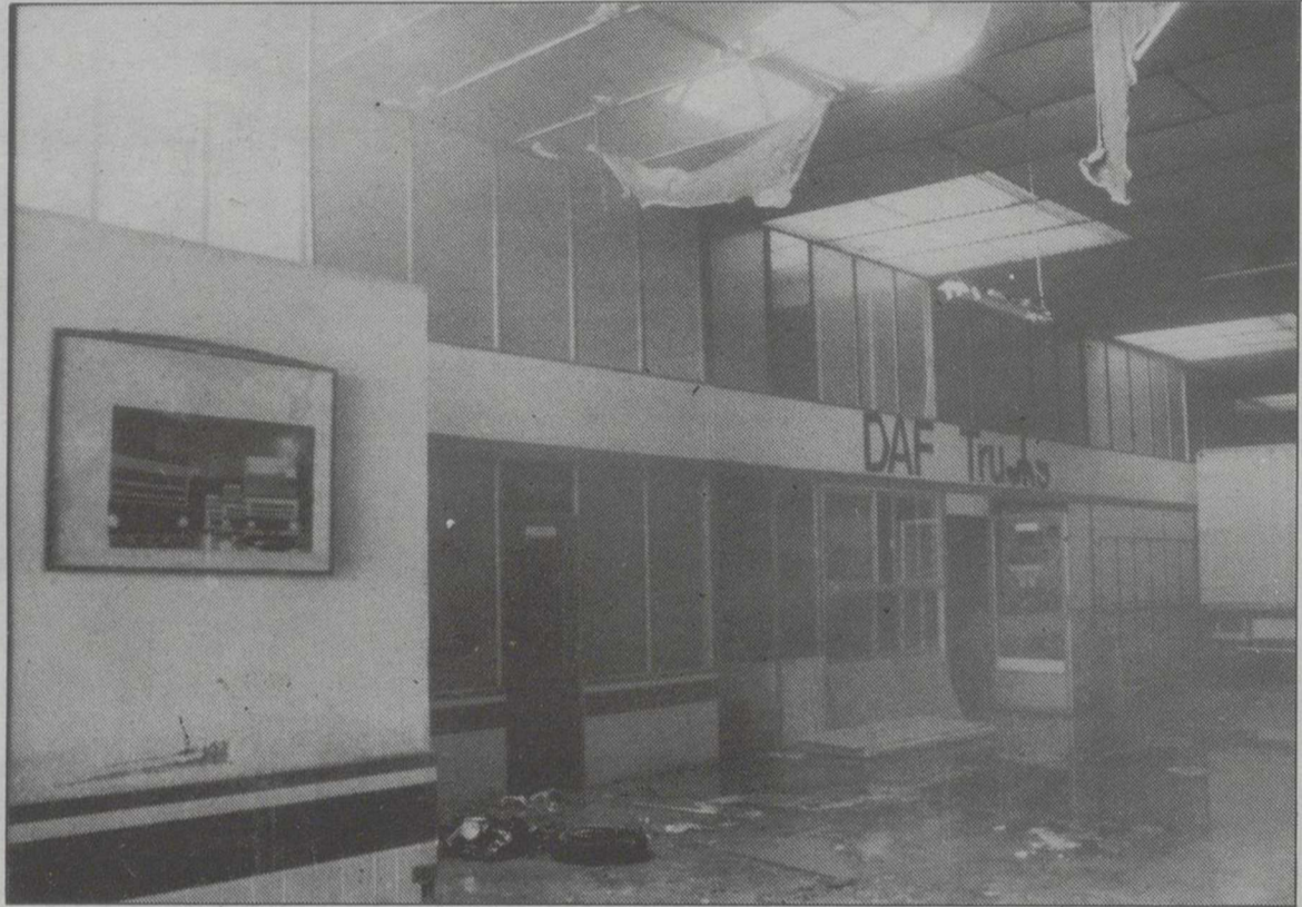
Un fallo en el fluido eléctrico provocó un incendio en las instalaciones de DAF Trucks. JESUS MORENO
