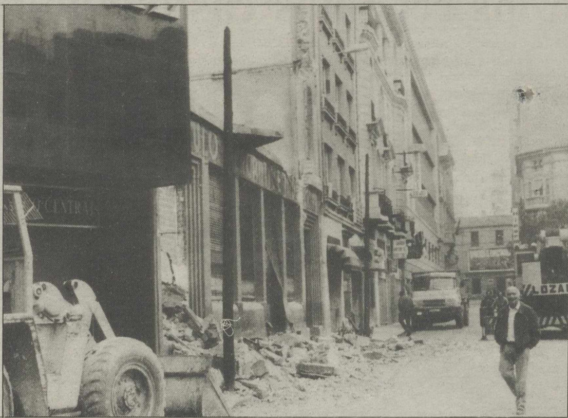
El edificio que fuera antigua sede de la Cámara de Comercio fue demolido, aún estando catalogado.
