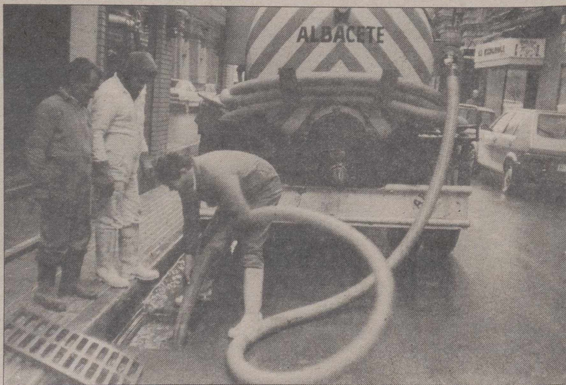
La falta de pendiente en la ciudad hace que los imbornales tengan que ser revisados con más frecuencia.
