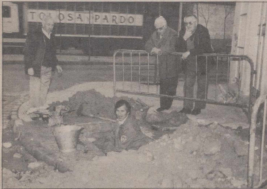
La red de aguas, vieja e insuficiente, provoca averías y los consiguientes cortes de suministro.
