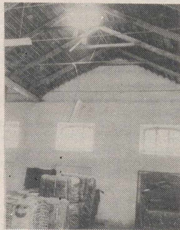
A medio metro de donde cayó, unos pilares de cartones, que hubieran amortiguado la caída. Arriba, el agujero por donde se precipitó.
