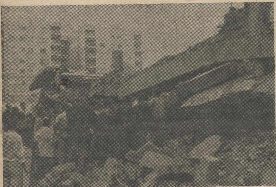
ALMERIA.—Aspecto del hundimiento de la casa en construcción, de diez pisos, en la calle Hermanos Pinzón de esta capital. Unos treinta obreros quedaron enterrados entre los escombros. Hasta ayer, fueron rescatados con vida cinco obreros, se extrajeron cuatro cadáveres y se sabe que existe alguno más con vida, pero atrapados entre las vigas.
