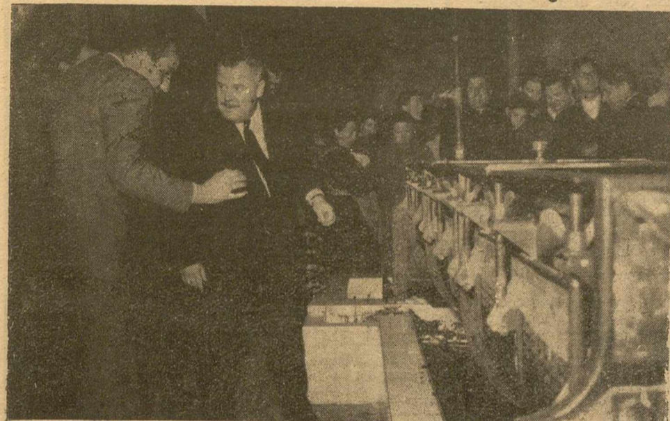
El delegado provincial sindical, escucha las explicaciones que sobre el funcionamiento de la moderna maquinaria instalada en la almazara de Alcaraz, le da el agente para la zona donde está encuadrada nuestra provincia, de la Casa "Marrodán y Rezola, S. A."
