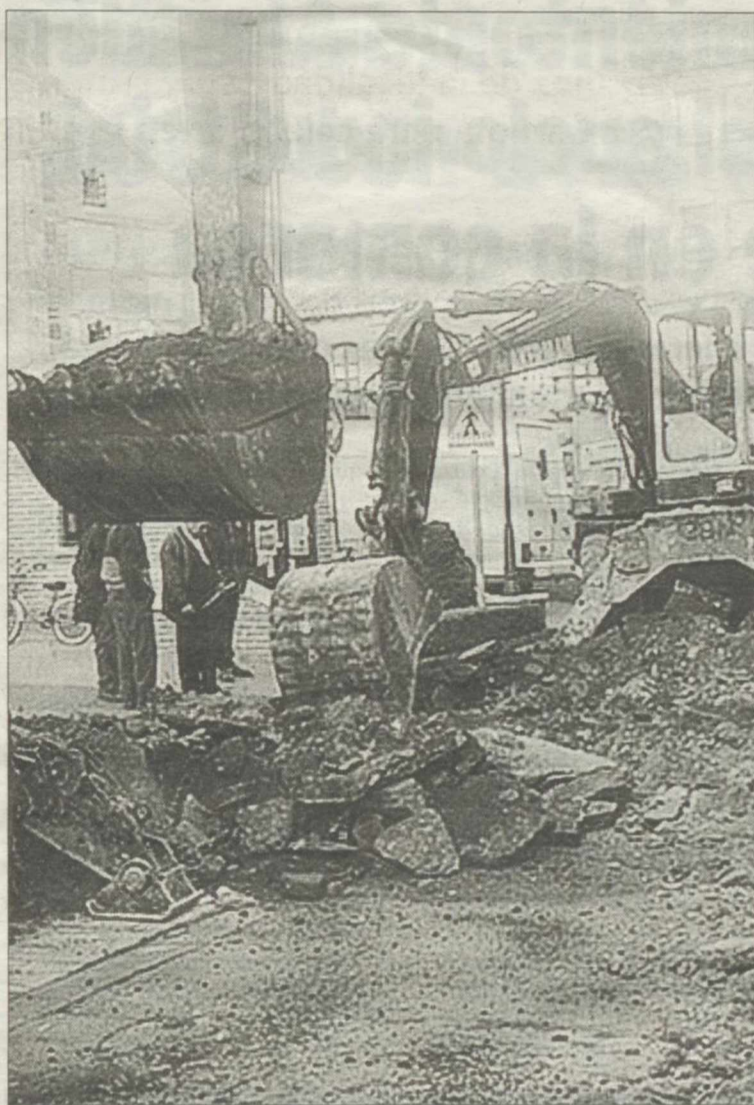
Imagen de las obras en la Plaza de la Constitución y España. / AG
