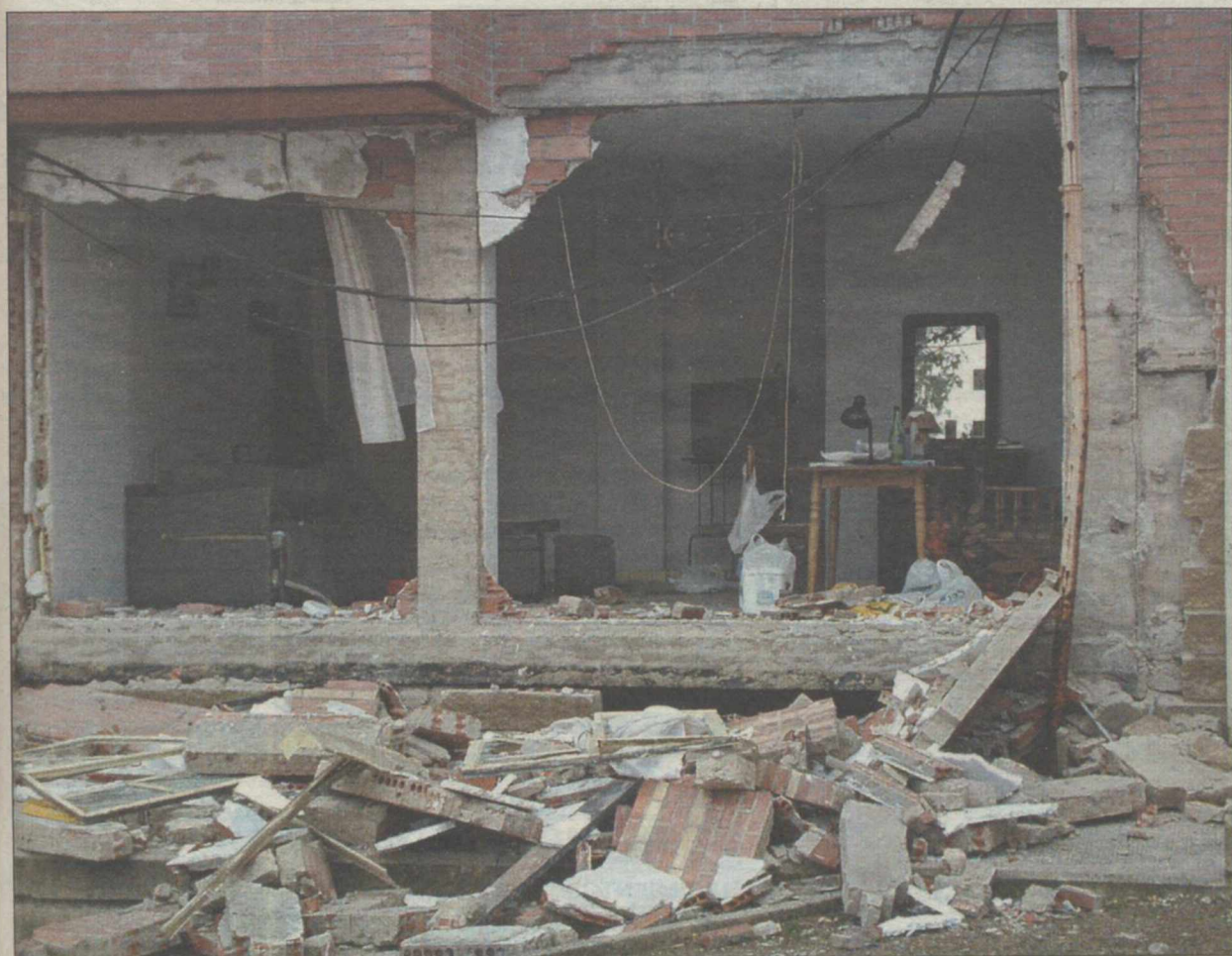
Estado en el que quedó la vivienda de Puertollano tras la deflagración por la acumulación de gas butano
