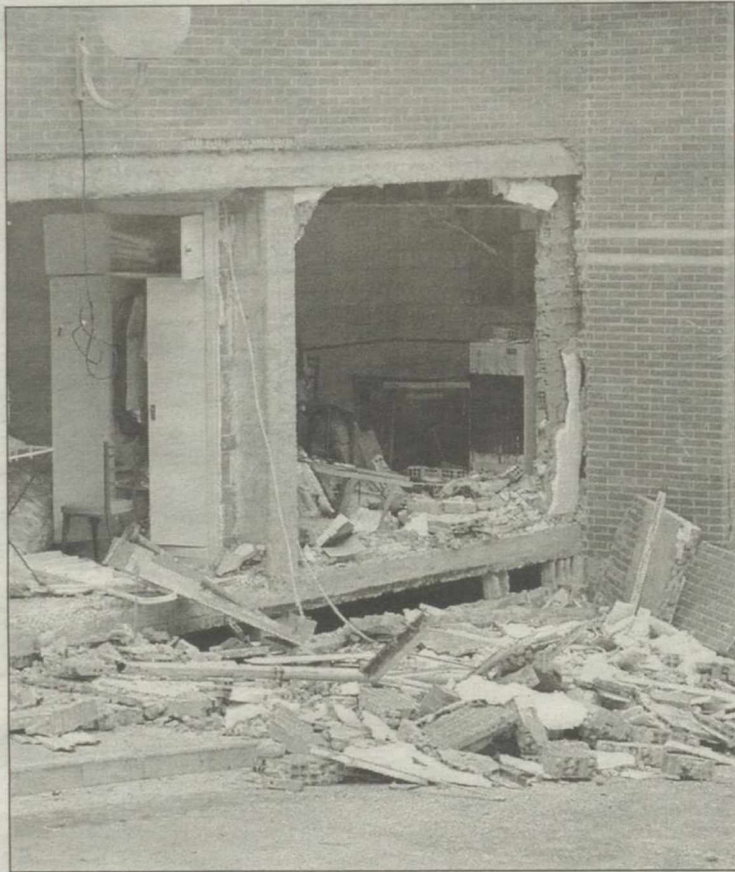
Estado en el que quedó el exterior del edificio
