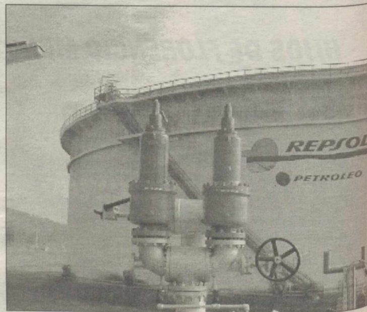
Instalaciones de Repsol en Puertollano
