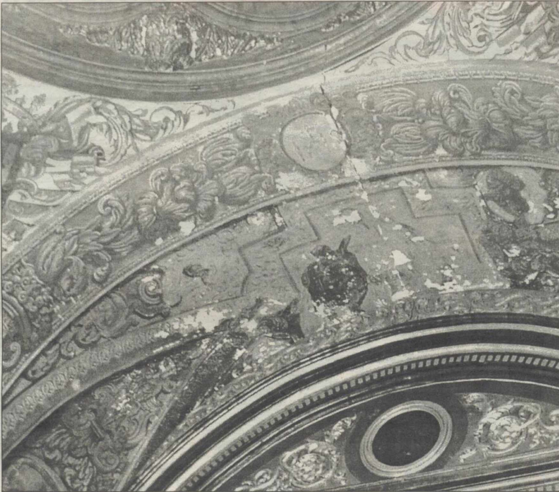
Los frescos de la capilla aparecen seriamente deteriorados
