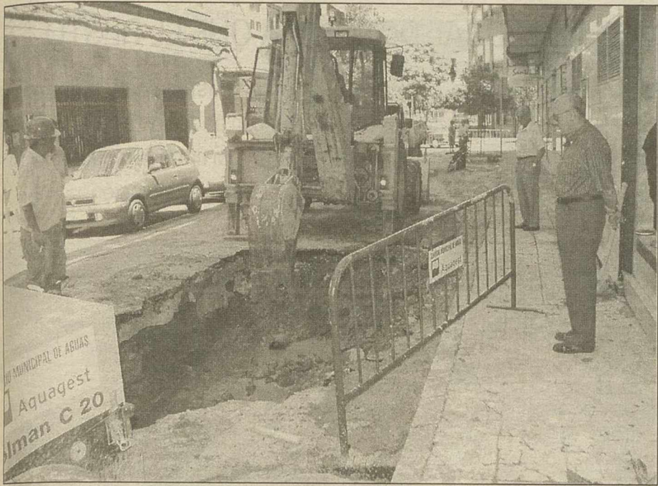
Cinco operarios y técnicos se afanaban en la reparación de la avería de la calle Olivo Rueda
