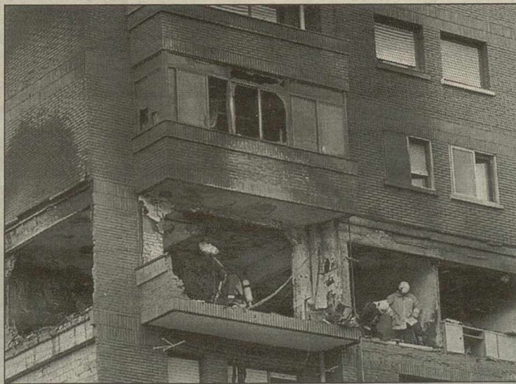
El edificio quedó muy dañado tras el incendio
