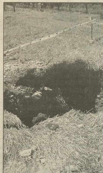
Socavón por la avería Rueda Villaverde
