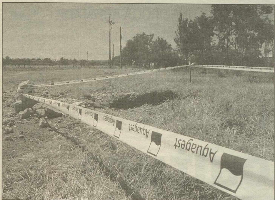
Aquagest acordonó la avería de la tubería general enfrente de la Calatrava Rueda Villaverde
