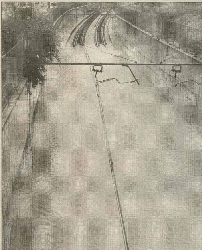
Las vías férreas quedaron cortadas debido a las inundaciones.
