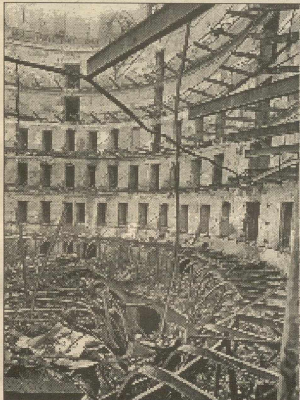
Una chispa de soldadura originó el incendio que destruyó el Liceo.
