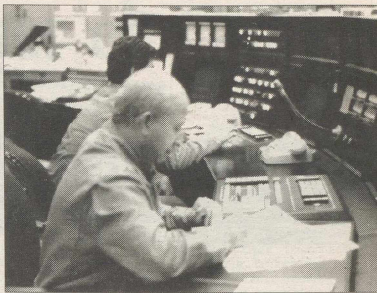
Sala de control de una de las plantas de Enfersa.
