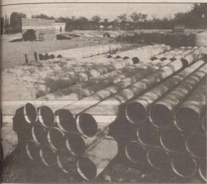
Las obras han comenzado sin licencia.
